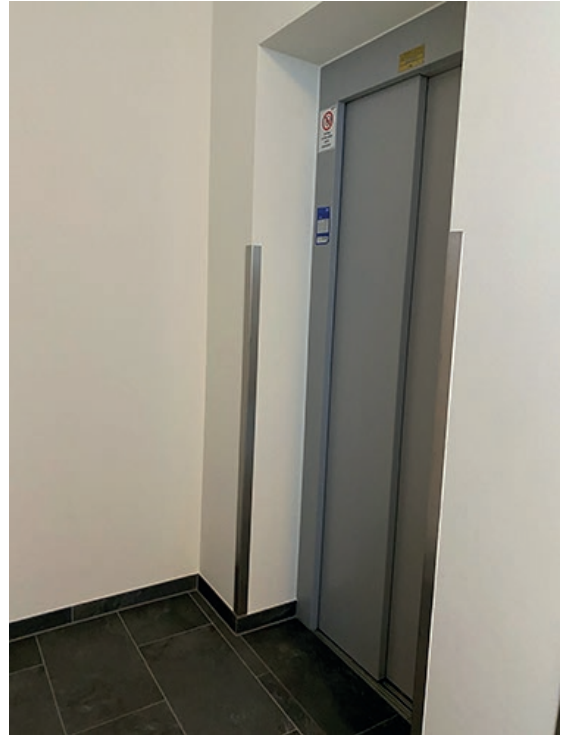
Lift im Haus
